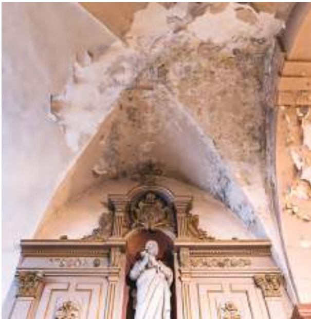
Des infiltrations d'eau successives ont endommagées l'église Saint-Pierre.
